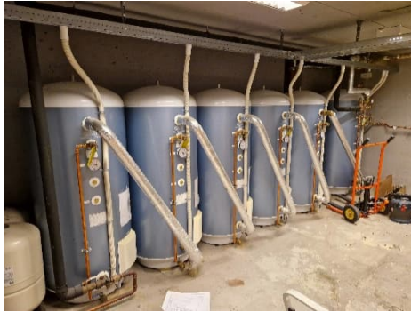
Bilde 4 – Bilde fra teknisk rom
