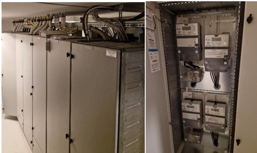
Bilde 6 Hovedtavler og sikringskap. Nytt og oppgradert.
